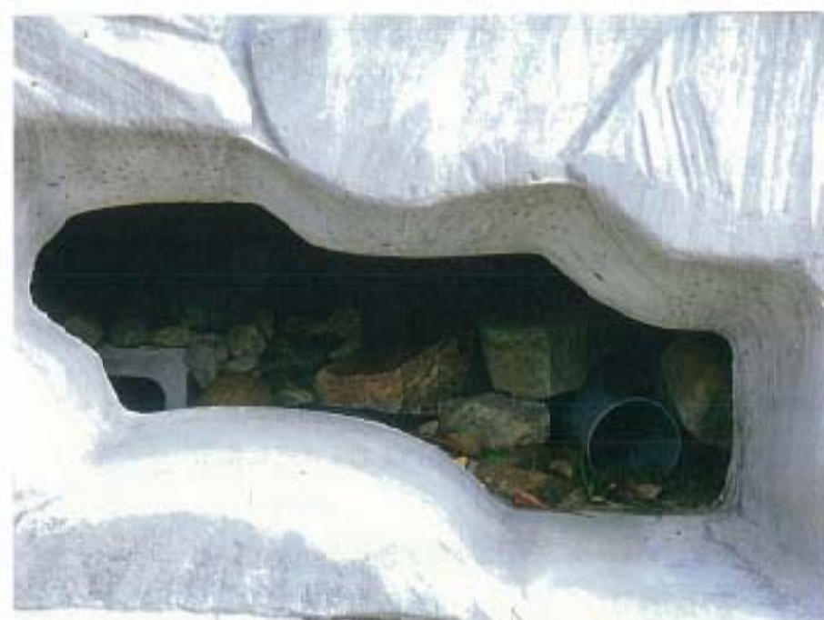
写真1 はんざきブロックII型の大きすぎる出入口
