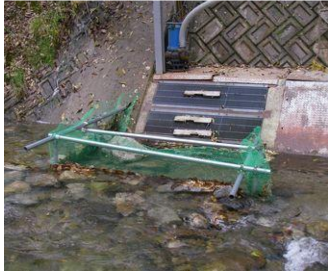
写真2 ポンプ・ピットの落ち葉対策
